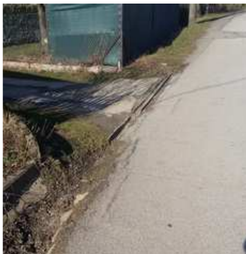
Obr 16: stávající nefunkční koryta
