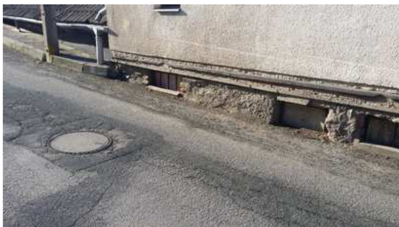
Obr 4: sklepní okno zalité asfaltem
